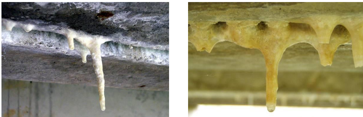
Рис. 1. Общий вид сталактитов на нижней поверхности бетонных конструкций моста через р. Нерль: слева – сталактиты белого цвета, справа – ожезненные сталактиты желтого цвета
