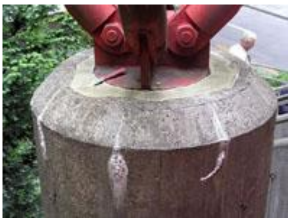
Рис. 10. Натечная кора на бетонной опоре в Берне
